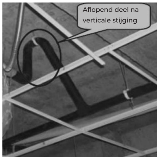
Aflopend deel van afvoerleiding
